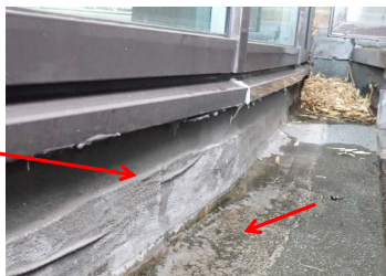
Afb 13. Aanzicht van de craquelé in de coating.
