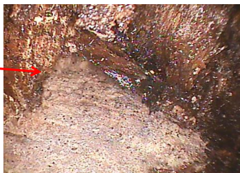
Afb 8. Aanzicht aangetaste houten raamwerk onder de pui.
