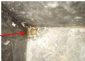
Afb 2. Detailopname van water onder één van de convectorputten.
