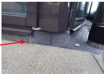
Afb 15. Aanzicht van de craquelé in de coating.
