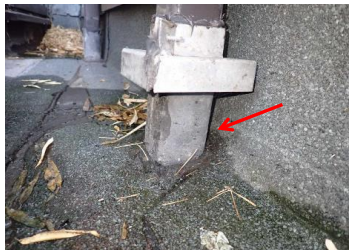
Afb 17. Aanzicht geringe ruimte tussen baluster en dakrand.
