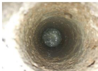
Afb 4. Detailopname van water in de vloer t.p.v. kernboring 1.
