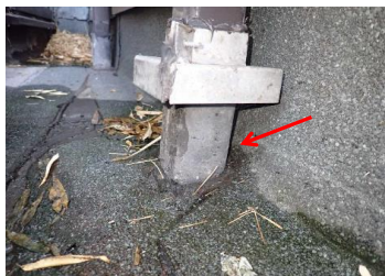
Afb 17. Aanzicht geringe ruimte tussen baluster en dakrand.
