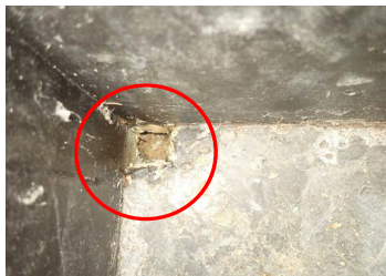
Afb 6. Aanzicht van water op de constructieve vloer in één van de convectieputten.
