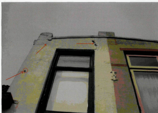
Foto 6: Scheuren en loszittend stucwerk vanaf de dakrand tot bovenkant raamkozijn in de voorgevel van nr. 42. Links op de foto op ongeveer de halve hoogte van de opbouw is te zien dat het muuranker niet meer volledig aanwezig is.
