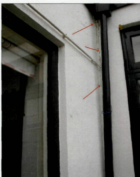
Foto 10: Scheurvorming aansluiting achtergevel-uitbouw nr. 42.
