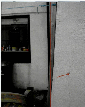
Foto 7: Duidelijke indicatie van de scheefstand van de achtergevel van nr. 42, genomen aan het eind van de steeg nabij de poort. De houten balk, waar de waslijn aan bevestigd is, is door de bewoner aangepast aan de scheefstand. Zie ook de scheurvorming in de linkerzijgevel (gele pijl).
