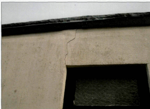
Foto 11: Doorgaande scheur vanaf de dakrand tot raamkozijn in de uitbouw van nr. 42.
