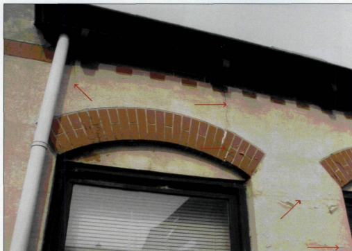
Foto 3: Doorgaande Scheur vanaf de dakrand tot in de toeg bij nr. 40 in de voorgevel. Ook scheur rechts van hemelwaterafvoer. Ook horizontale scheurvorming in het stucwerk ter plaatse van de muurdam rechts van het raam.
