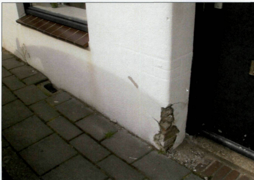
Foto 4: Losgekomen stucwerk nabij de voordeur van nr. 42.
