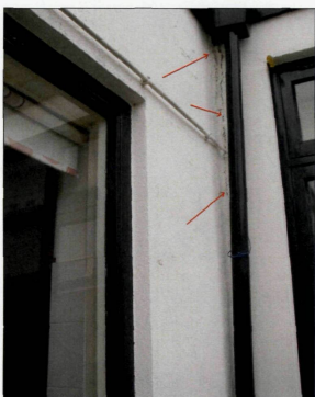
Foto 10: Scheurvorming aansluiting achtergevel-uitbouw nr. 42.
