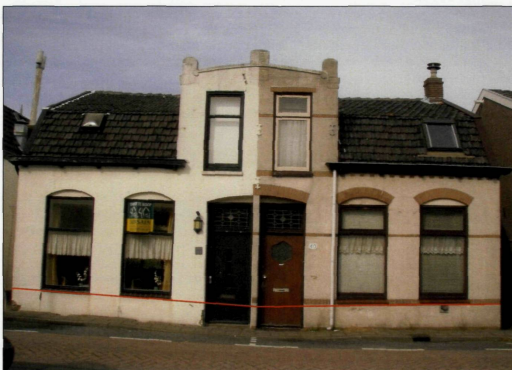
Foto 1: Voorgevels nummer 40 en 42. Duidelijk is de scheefstand c.q. verzakking te zien bij nummer 42 (links op de foto). Oorspronkelijk lagen de onderkanten van de raamkozijnen op 1 lijn.
