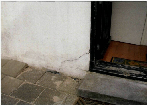
Foto 12: Scheurvorming (alleen in het stucwerk?) nabij voordeur nr. 42 en omhooggedrukte straattegel.
