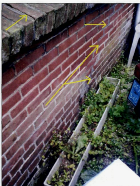
Foto 18: Aangeheelde scheuren in borstwering en scheur in voeg raamdorpelsteen.
