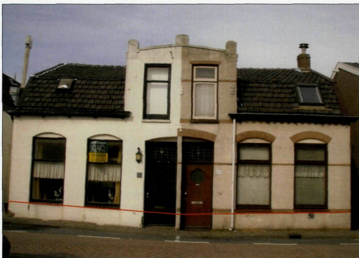
Foto 1: Voorgevels nummer 40 en 42. Duidelijk is de scheefstand c.q. verzakking te zien bij nummer 42 (links op de foto). Oorspronkelijk lagen de onderkanten van de raamkozijnen op 1 lijn.
