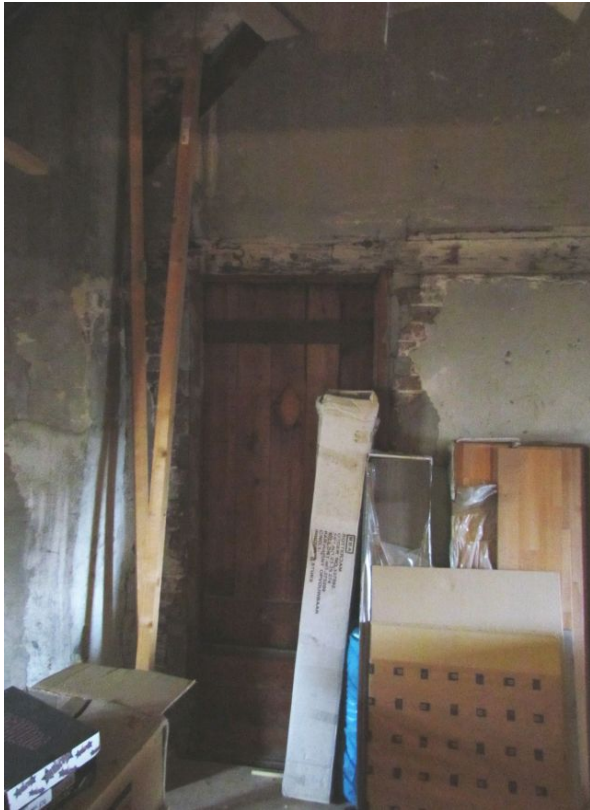
Branddeur zolderverdieping tussen 36 en 38.
