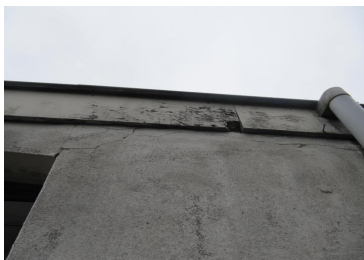
Foto 5: Dakrandbetimmering achtergevel vertoont houtrot
