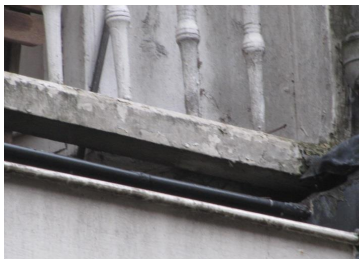
Foto 6: Houten hekwerken vertonen houtrot
