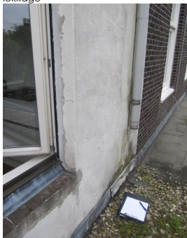
Foto 4: Hemelwaterafvoer, deel ontbreekt
