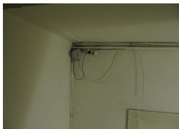
Foto 2: Plaatselijk losse kabels / bedrading trappenhuis
