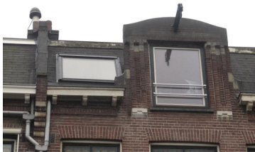
Foto 4: Schuin dakvlak vertoont openingen singels
