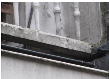
Foto 6: Houten hekwerken vertonen houtrot
