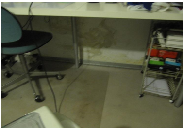
Foto 3: Vochtige wanden onder bureau Souterrain
