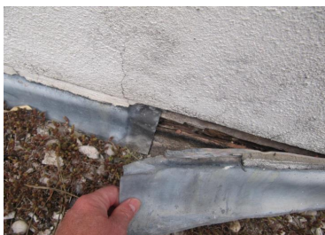
Foto 2: Voetlood ligt los, opstand is te laag met kans op lekkage
