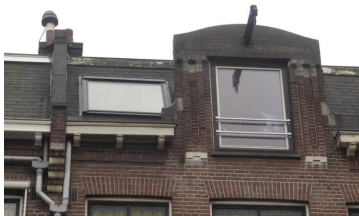
Foto 4: Schuin dakvlak vertoont openingen singels
