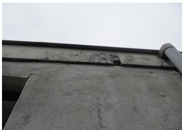
Foto 5: Dakrandbetimmering achtergevel vertoont houtrot
