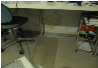
Foto 3: Vochtige wanden onder bureau Souterrain
