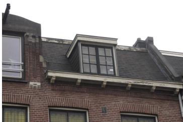
Foto 3: Gooten dakrandbetimmering vertoont houtrot
