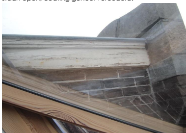
Foto 5: zicht op houten dakranden, schilderwerk noodzakelijk
